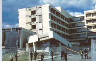
Edificios médicos pueden ser dañados o destruidos. (Foto USGS)
